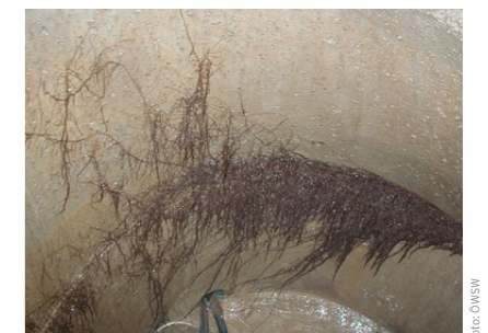
Schacht mit eingewachsenen Wurzeln
